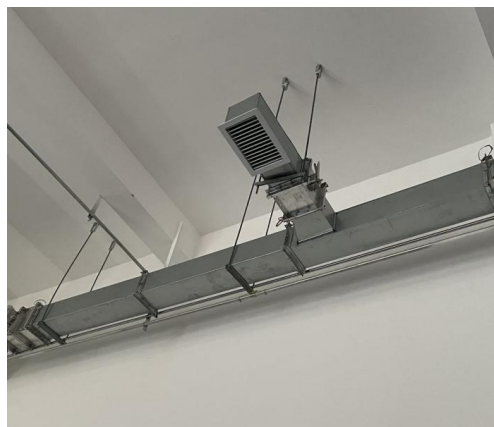
仓库内废气收集口和管道
