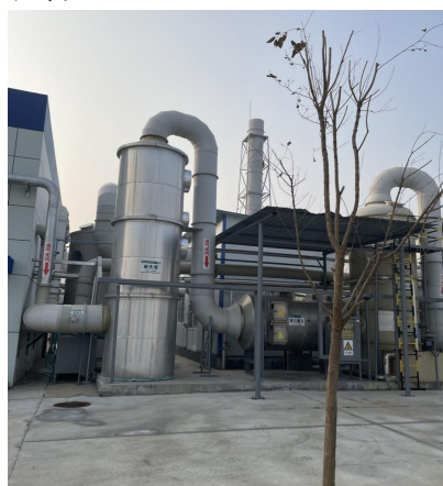
废气处理设施
